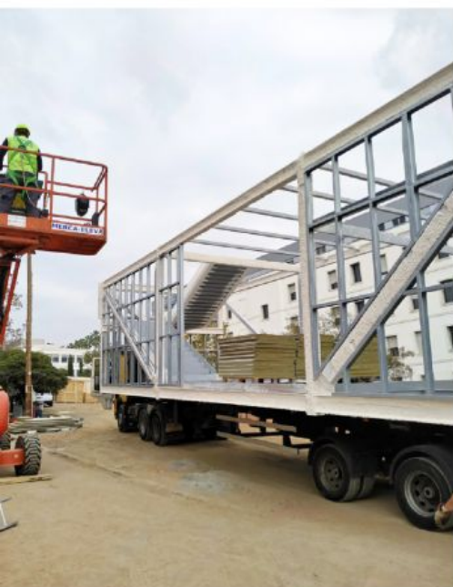
Els mòduls que formen l'estructura de l'hospital arribant a l'obra, provinents dels tallers on s'han manufacturat.
